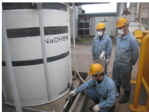
四国製造所（地震による配管亀裂での薬液の漏洩）
