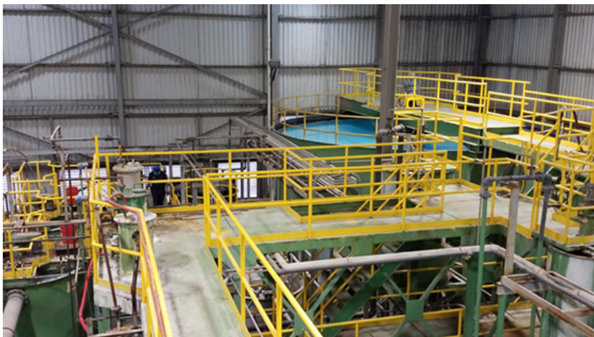
ダブリン工場の排水処理システム
