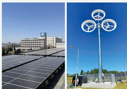
左はYKK AP大連社に設置された太陽光パネル。 右は黒部越湖製造所に設置された風力発電設備
