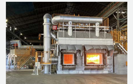
四国製造所のリサイクル炉。左奥は材料の自動投入機
