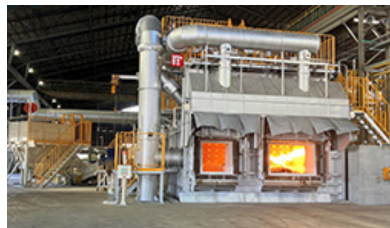
四国製造所 リサイクル炉
